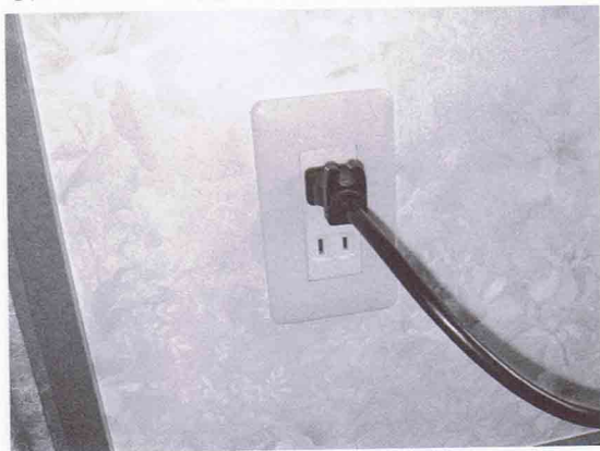
写真2 コンセントもしっかり管理
